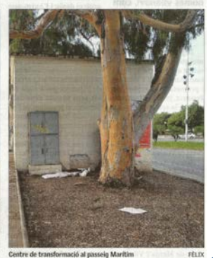
Centre de transformació al passeig Marítim
